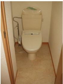
リビングタウン西浦B102 温水洗浄便座
